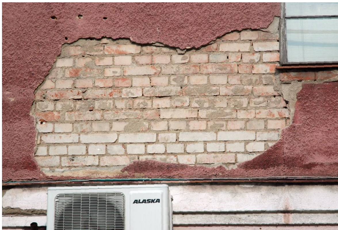
Widoczne spęcherzone tynki, odpadające od ceglanego podłoża.
